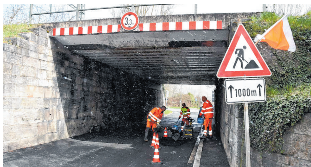
Statt einer Sperrung der L 511 am Bahndurchlass bei Lauda, die für diesen Mittwoch vorgesehen war, kam es am Dienstag nur zu kleineren Behinderungen. Die Frostschäden wurde provisorisch gefüllt, die Maßnahme verschoben. BILD: DIANA SEUFERT
